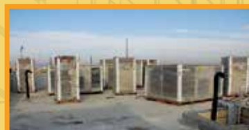
ورود دستگاه های هواساز و سیستم تهویه مطبوع
