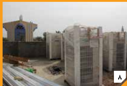
۸ ورود دستگاه های سیستم سرمایش و گرمایش ساختمان
